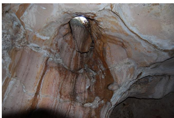
Imagen 6. Grietas en el techo
